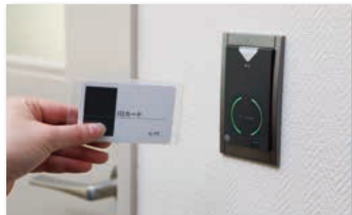
入退室管理システム
