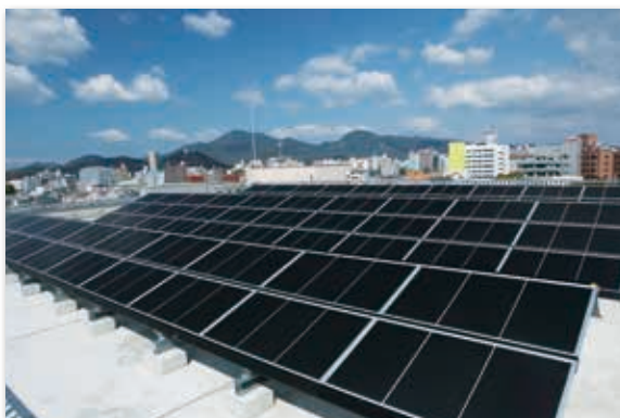
太陽光発電システム
